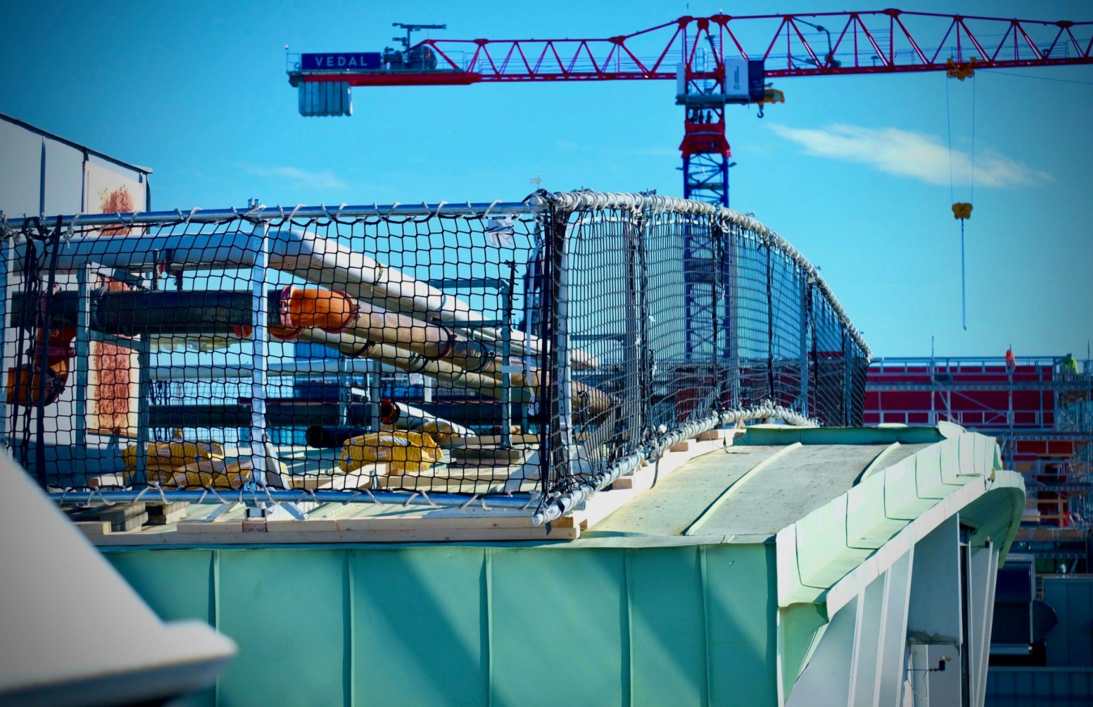
40 meter sikring av verneverdig metall tak for takarbeid midt i Oslo sentrum
